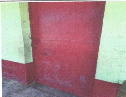
Foto 2: Se observa deterioro de pintura
