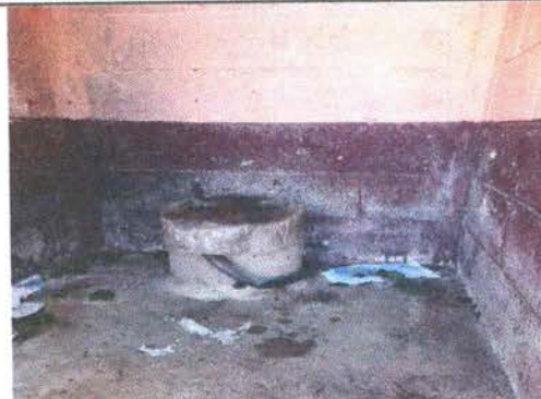
Foto 2: El inodoro está deteriorado, se necesita cambiar.
