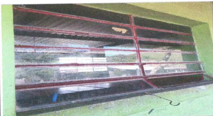
Foto 3: Se observa vidrios quebrados y balcones oxidados,
